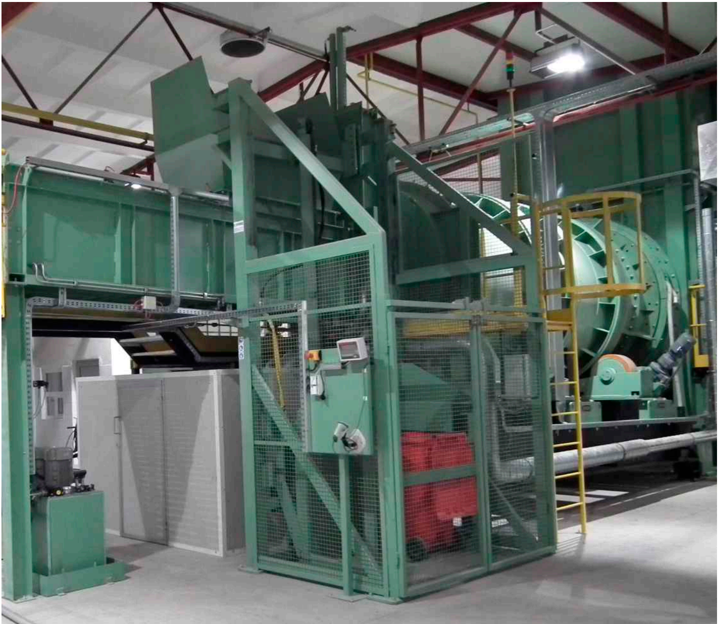
winda + tłoki hydrauliczne
