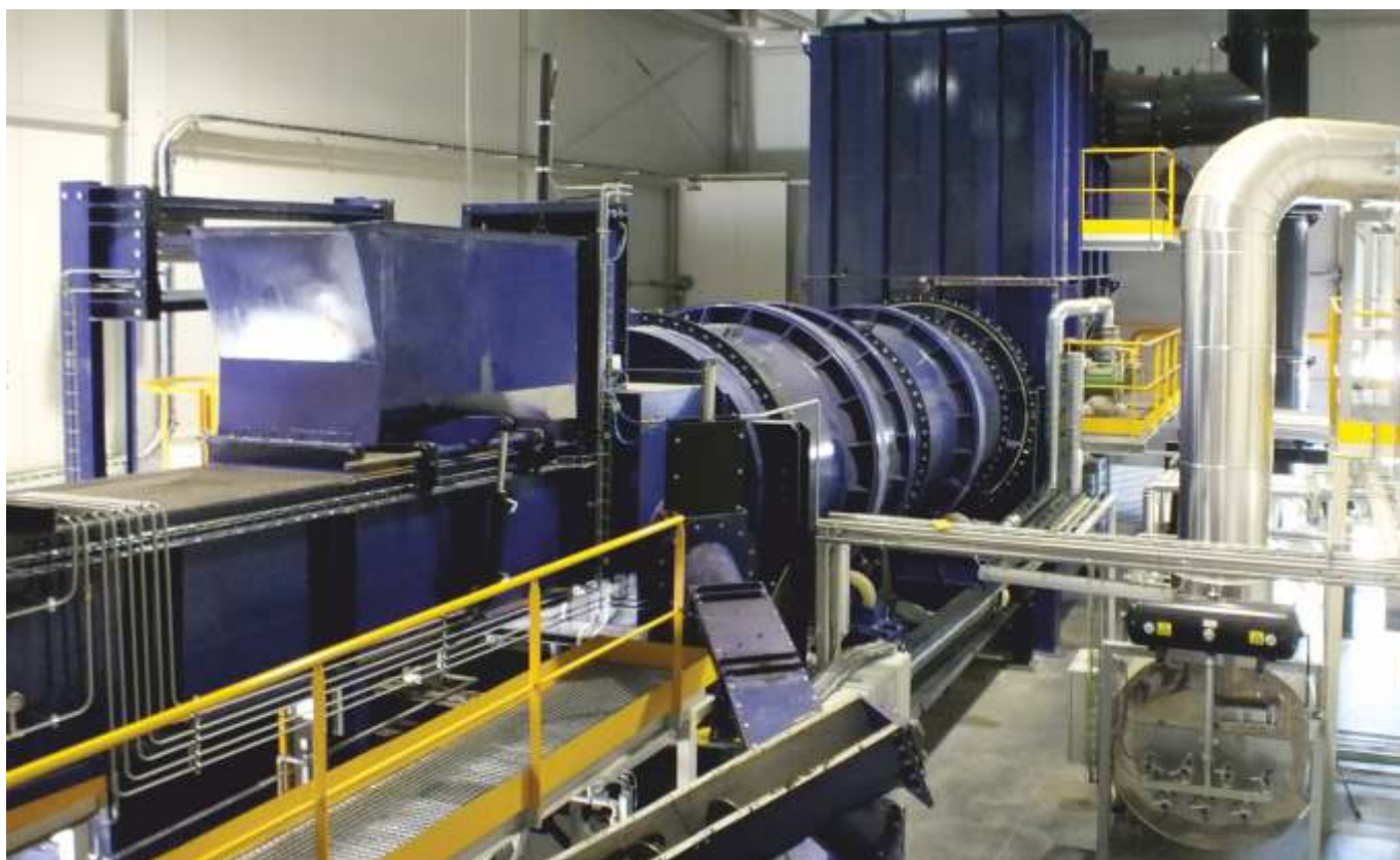
Spalarnia odpadów medycznych i zwierzęcych - Termo-Eko-Energia Sp. z o.o. w Chrzanowie.
