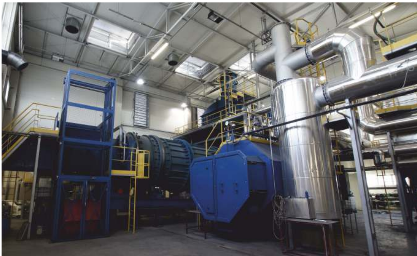
Spalarnia odpadów medycznych - Centrum Onkologii w Bydgoszczy.
