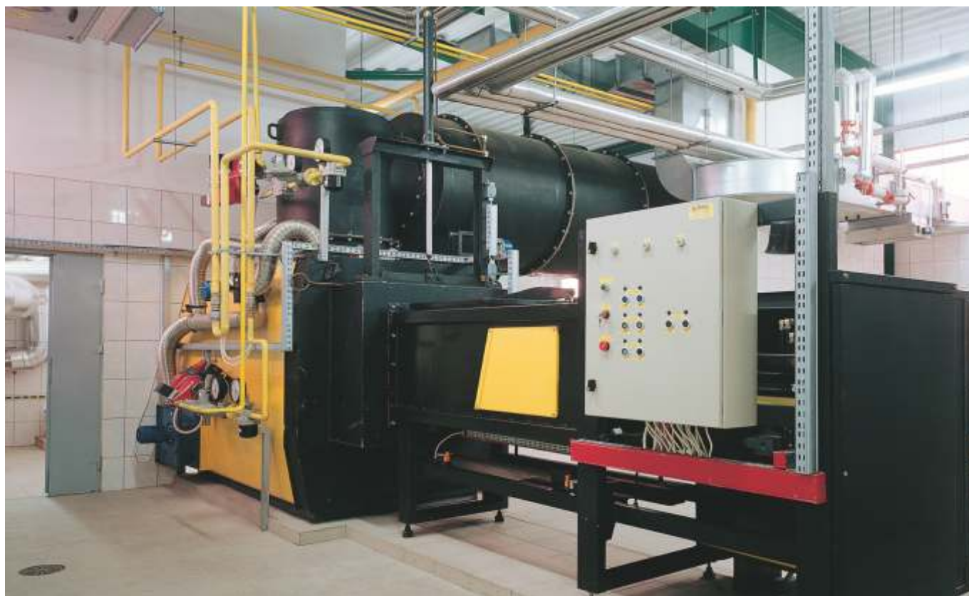
Spalarnia odpadów medycznych - Szpital Rejonowy w Chojnicach.
