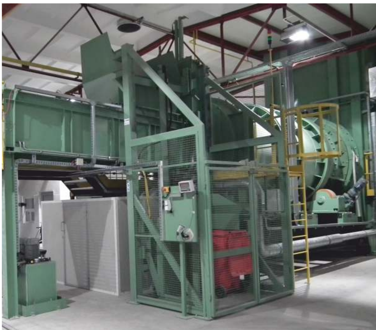
Winda + tłoki hydrauliczne.
