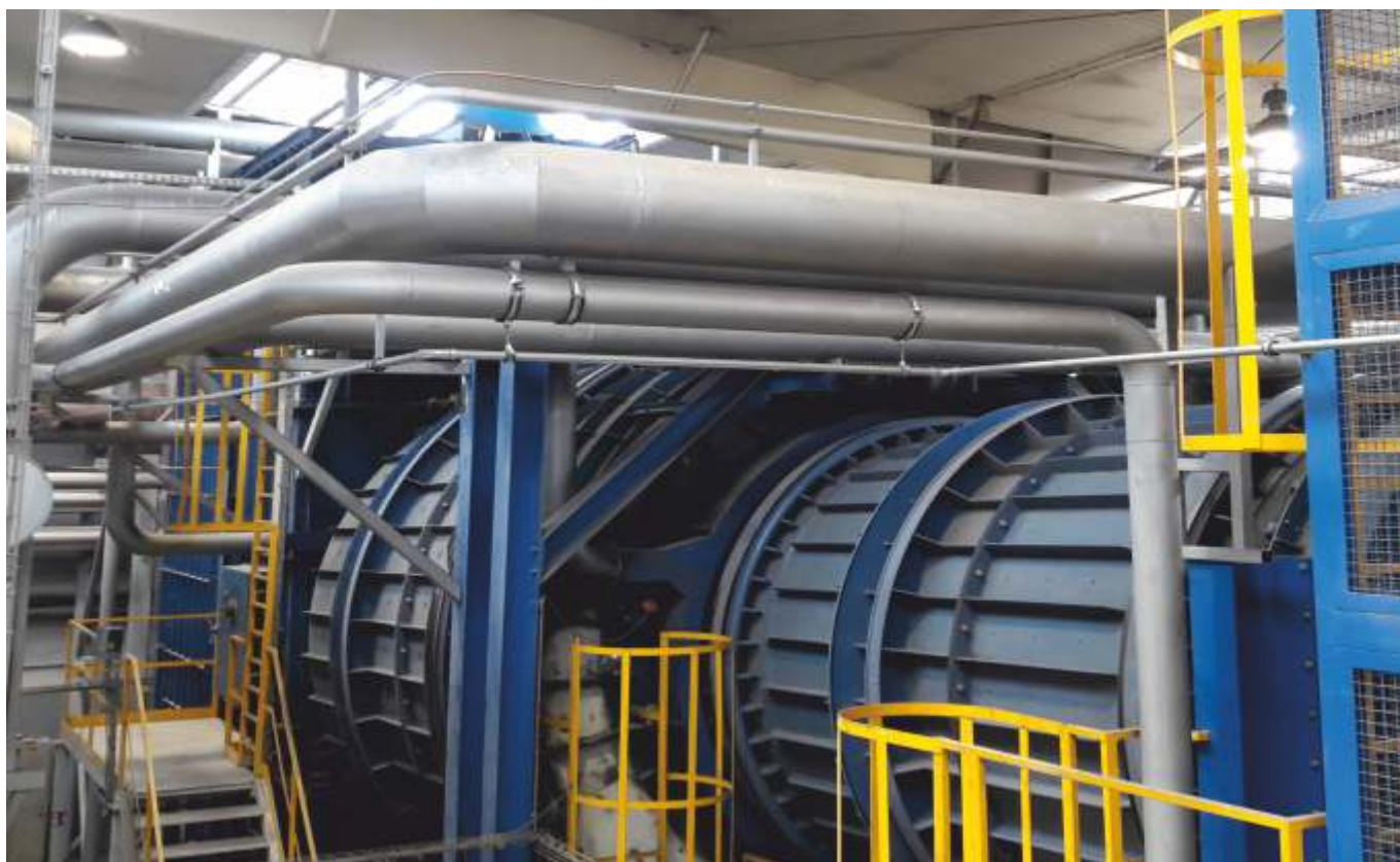
Spalarnia odpadów z tworzyw sztucznych z układem odzysku energii - SABA Sp. z o.o. w Płocku.
