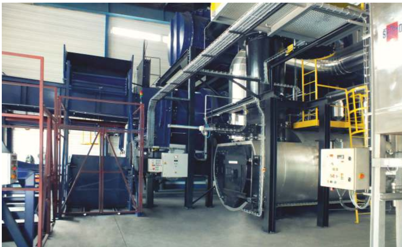
Spalarnia odpadów medycznych, weterynaryjnych i niebezpiecznych - ZUO Sp. z o.o. w Koninie.
