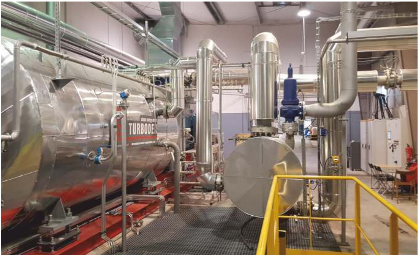
Moduł produkcji energii elektrycznej o mocy N=1000 kWe.
