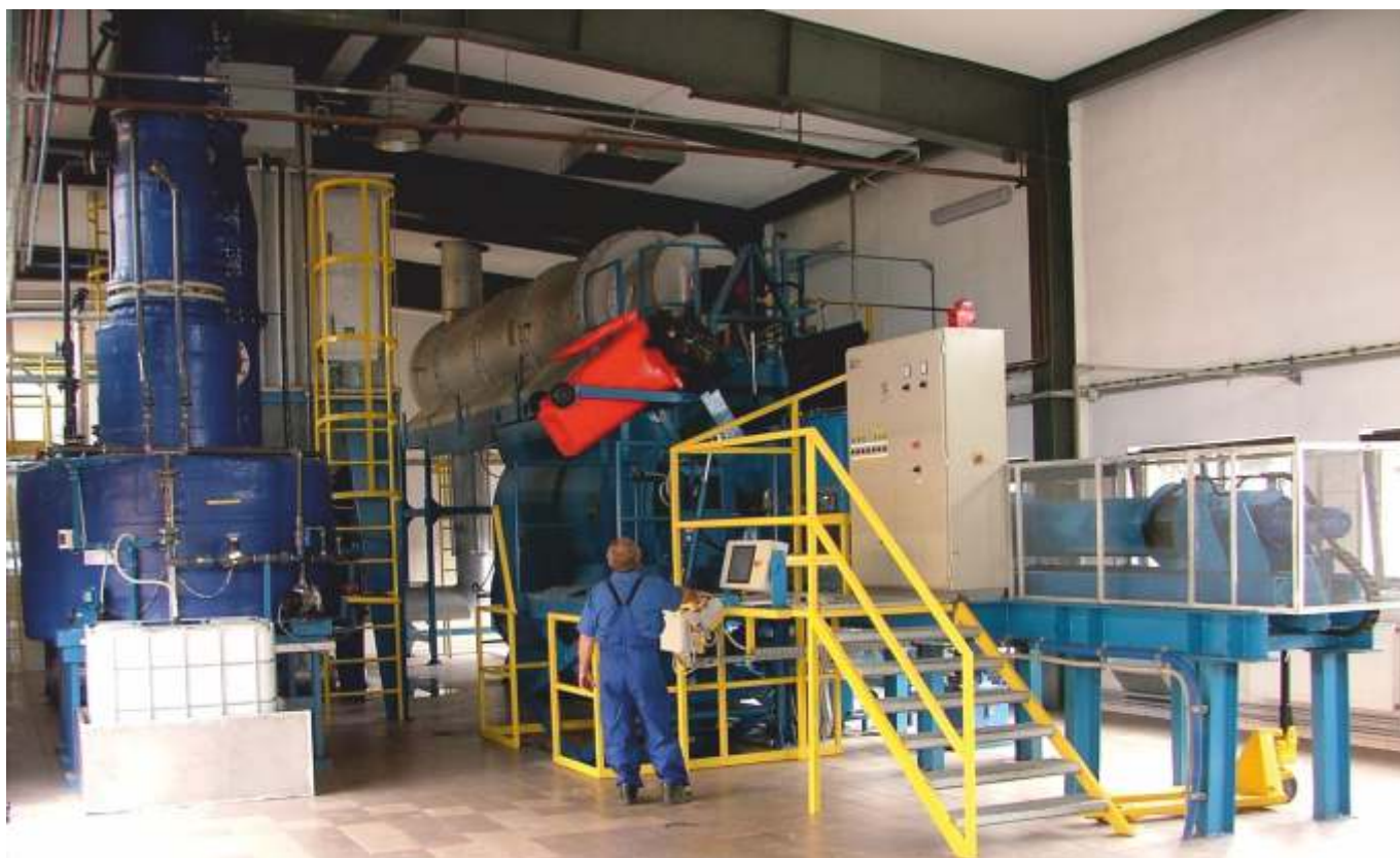
Spalarnia odpadów medycznych - Centrum Onkologii w Bydgoszczy.
