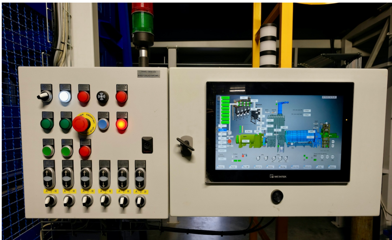
MONITORING I WIZUALIZACJA W EMKA S.A. W KĘDZIERZYNIE-KOŹLU - HALA TECHNOLOGICZNA
