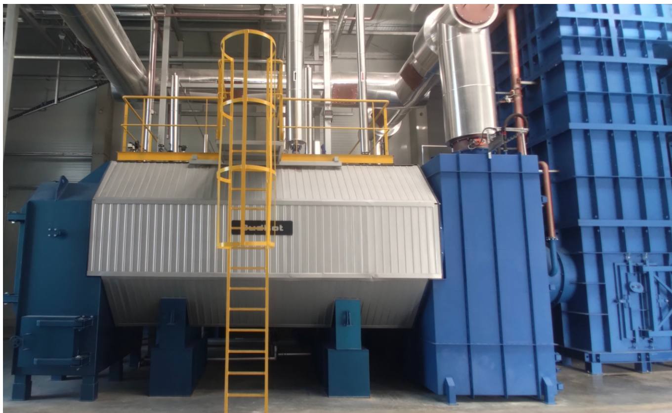
KOCIOŁ PAROWY ODZYSKNICOWY O MOCY Q = 1,5 MW
